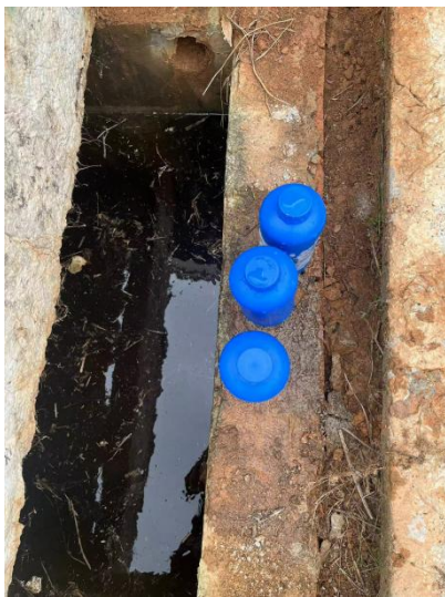
生活污水排放口
