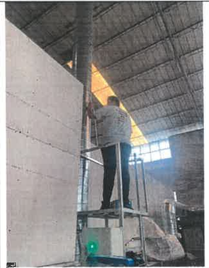
注塑废气排放口
