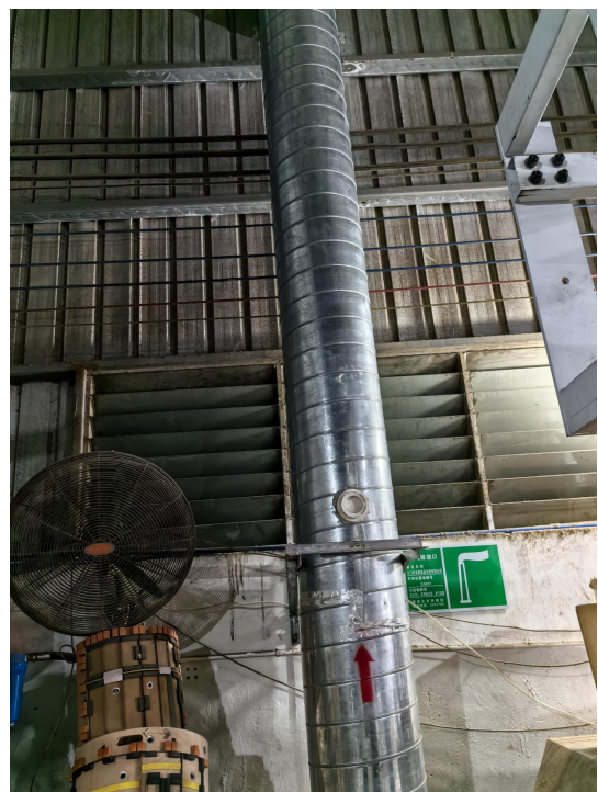
图 3.3-8 废气排气筒及采样口
