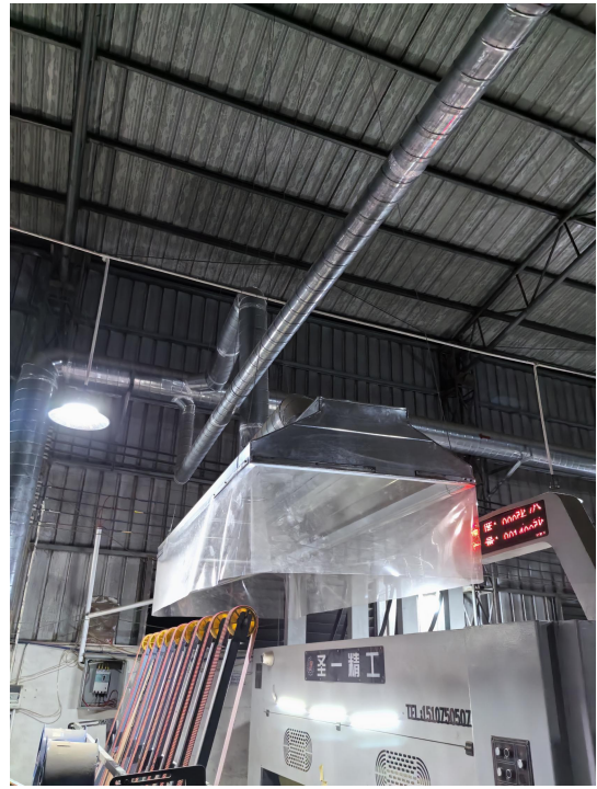
图 3.3-6 废气集气罩及管道
