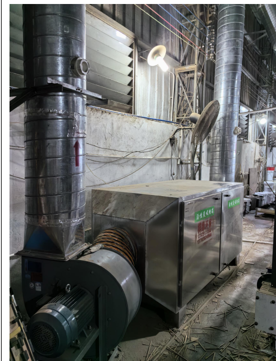
图 3.3-7 废气治理设施
